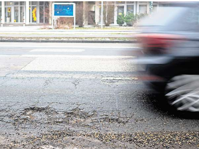
Schlagloch auf der Friedrich-Engels-Straße.
